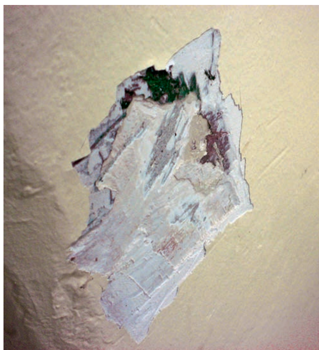
Abb. 1: Viele Farbschichten in den Wand- und Deckenbelägen
